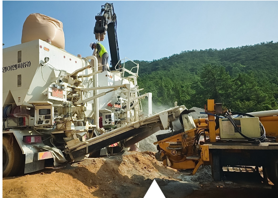
1종 콘크리트 생산
