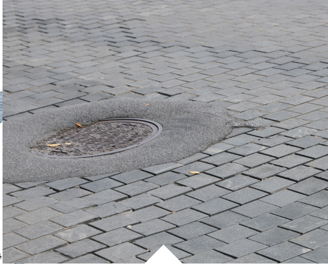
① 맨홀 주변부 파손
