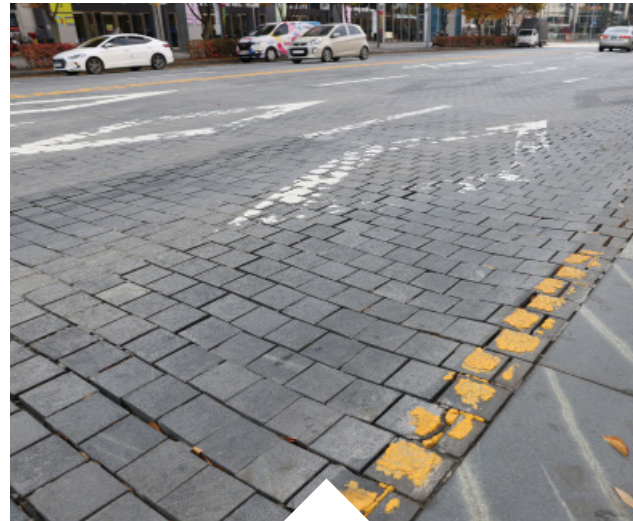
⑤ 중차량 통행구간 판석 파손 및 침하
