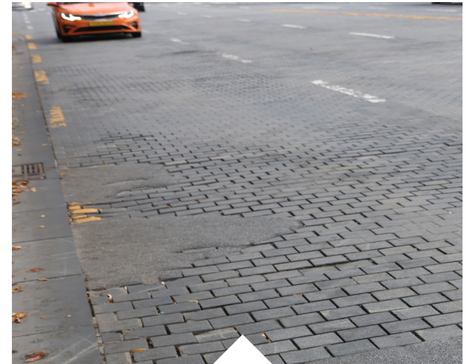
⑥ 중하중으로 인한 판석 파손
