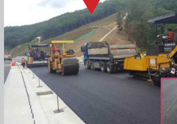
차로별 시공거리 이격(20~50m)에 따른 1,2차로 접속부 시공조인트 발생
